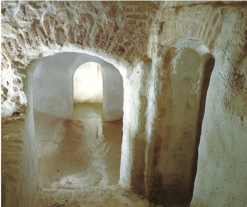
Obr. 31 Dům č. 21, nejnižší část sklepů s původní lednicí, zaplaveno
