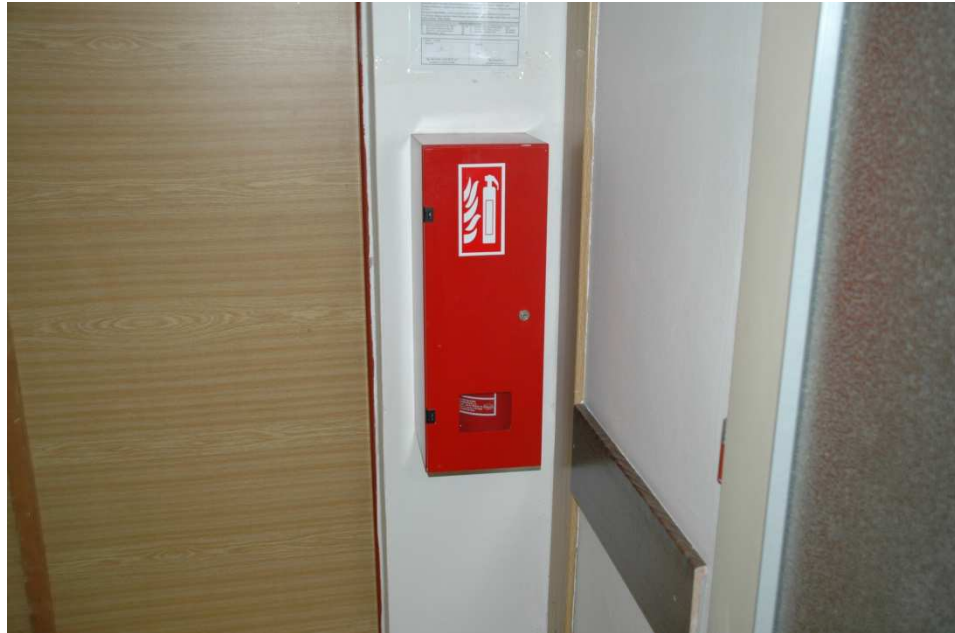
Obr. 18. Zamčený hasicí přístroj [zdroj vlastní]
