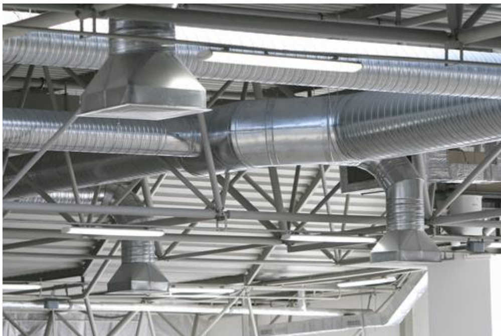
Obrázek 7: Ukázka centrálního rozvodu HVAC
