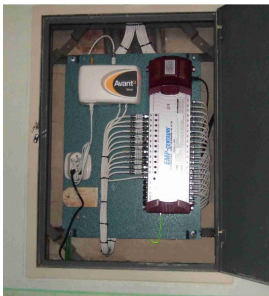
Obrázek 61 Osazení hlavní stanice v původní rozvodnici [vlastní zdroj]
