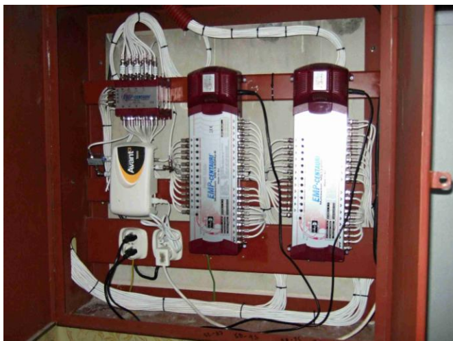
Obrázek 63 Osazení hlavní stanice v původní rozvodnici [vlastní zdroj]
