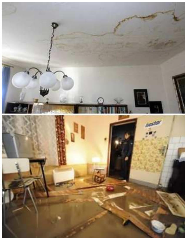
Obr. 9 Místnosti domu po úniku vody [14, 15]
