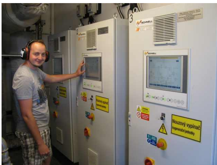
Obr. 6. Řídicí systém kogeneračních jednotek
