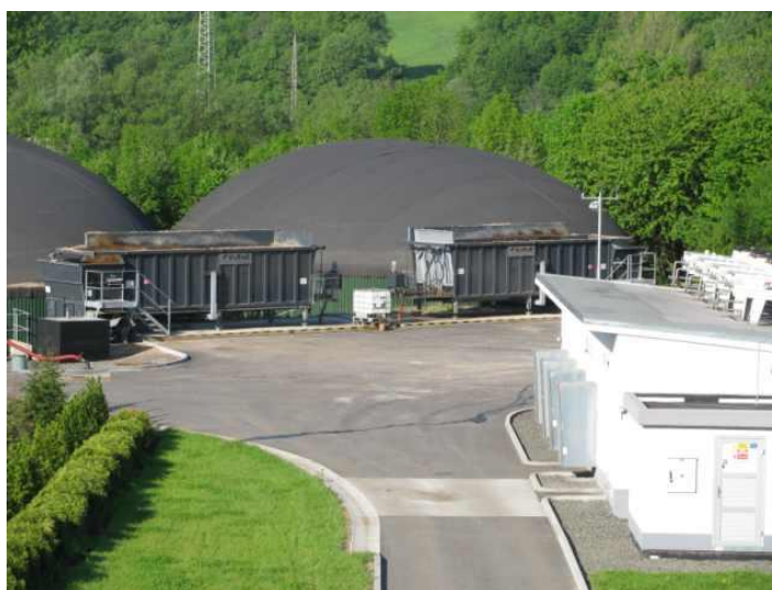
Obr. 2. Fermentační část stanice a strojovna KJ
