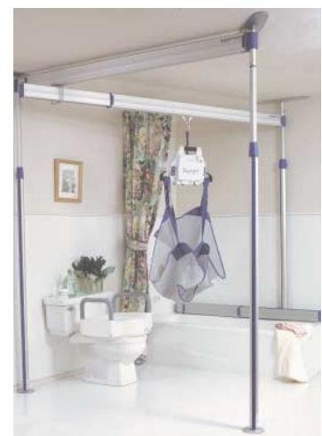
Obrázek 11: Složitá konstrukce vybudovaná v koupelně
