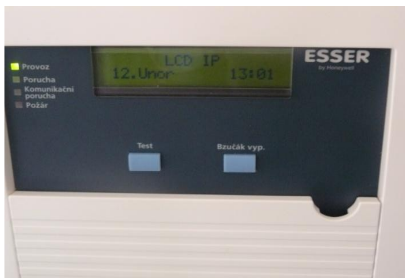
Obr.: 14 Terminál umístěný ve vedlejší budově domova pro seniory
