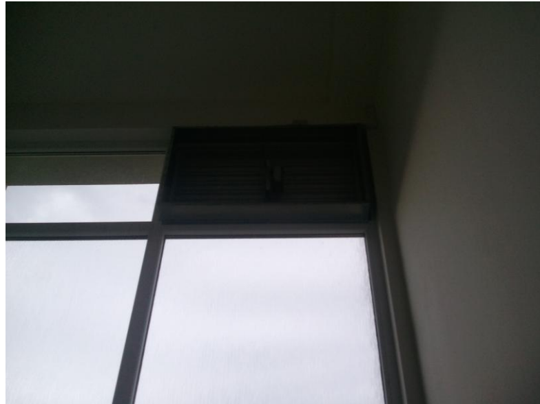
Obr.: 18 Požární klapka v prostorech schodiště
