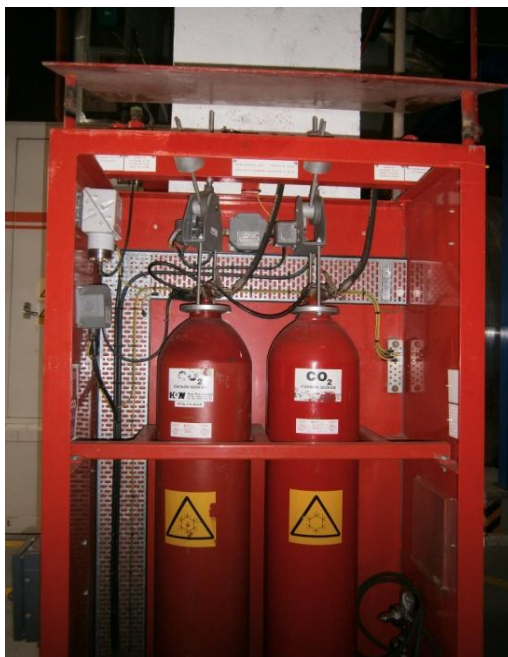
Obr. 10. Stabilní hasicí zařízení na CO 2 [Zdroj: vlastní]
