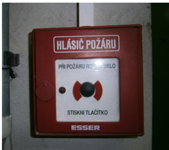
Obr. 11. Tlačítkový hlásič požáru [Zdroj: vlastní]
