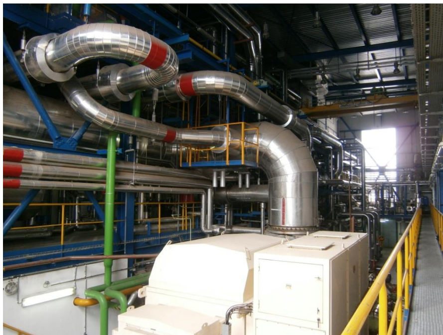
Obr. 5. Strojovna parní turbíny [Zdroj: vlastní]
