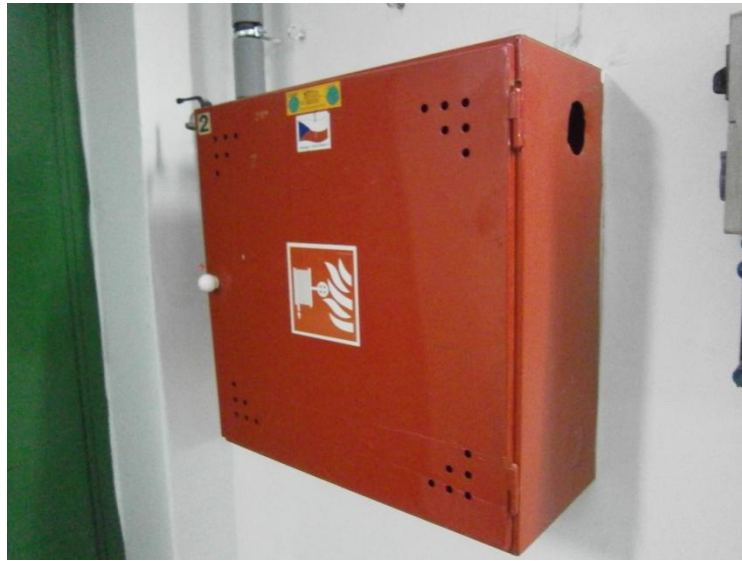
Obr. 8. Skříň s požární hadicí [Zdroj: vlastní]
