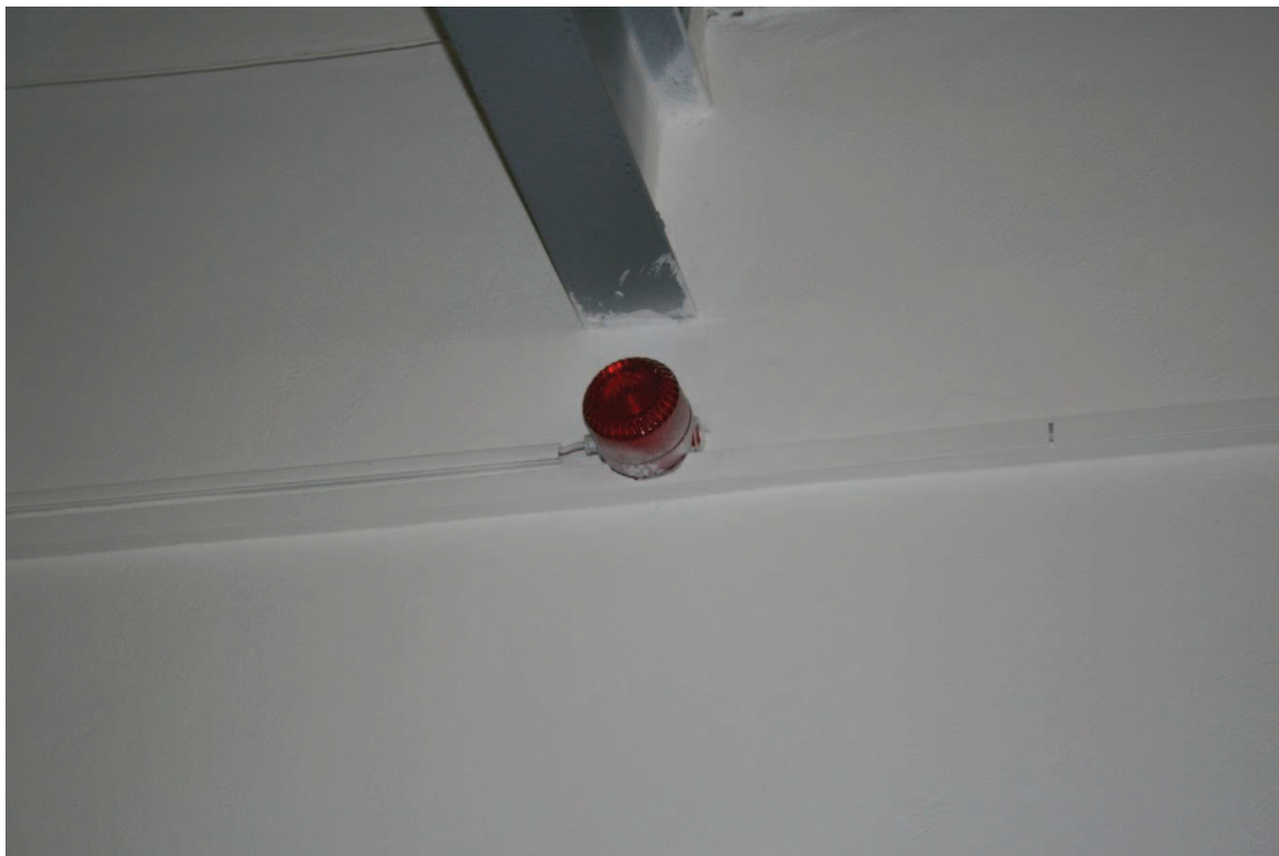
Obr. 27. Optický alarm EPS [Zdroj: vlastní]
