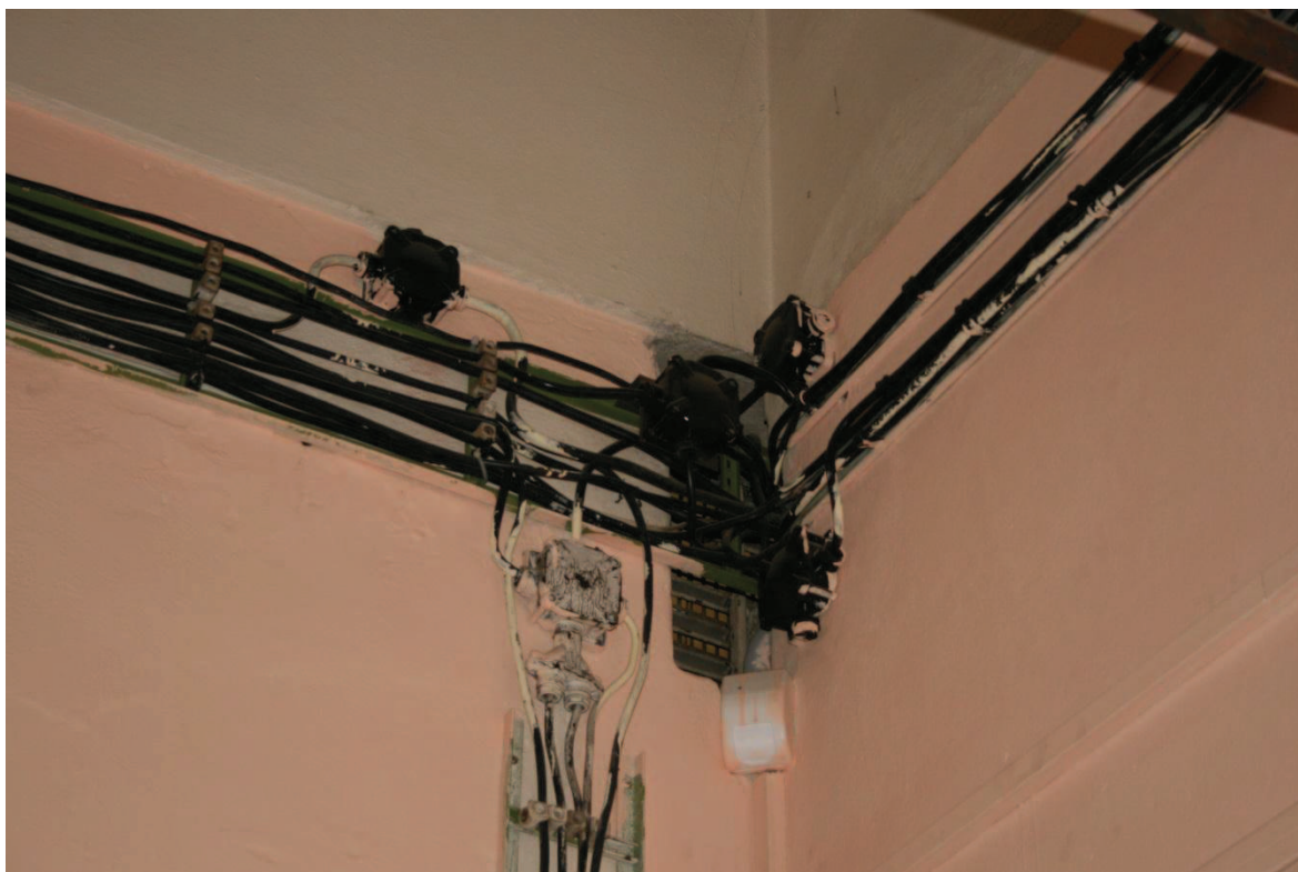
Obr. 25. Elektroinstalace [Zdroj: vlastní]
