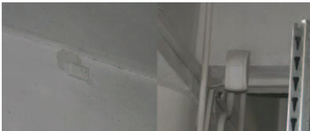
Obr. 11. Čidlo tříštění skla GS930N a PIR čidlo EV 525 [Zdroj: vlastní]
