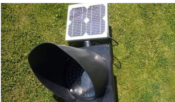
Obrázek 8 Fotovoltaický panel napájecí dopravní značku [21]
