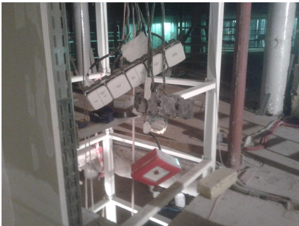
Obr. 23 Vícepráce vzniklé posunutím stěny
