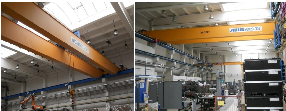
Obrázek č. 10 : Interní zdroje firmy mostové jeřáby
