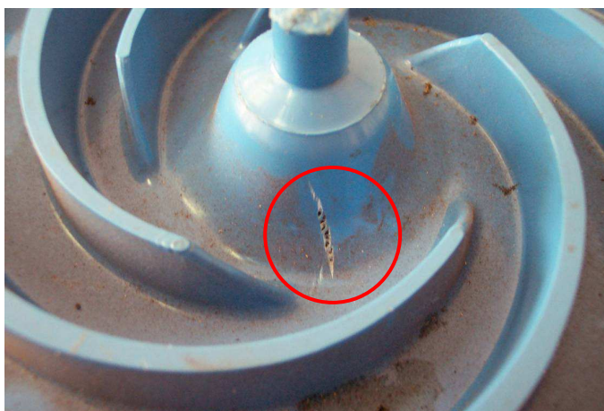
Obr. 6: Trhliny v oběžném kole
