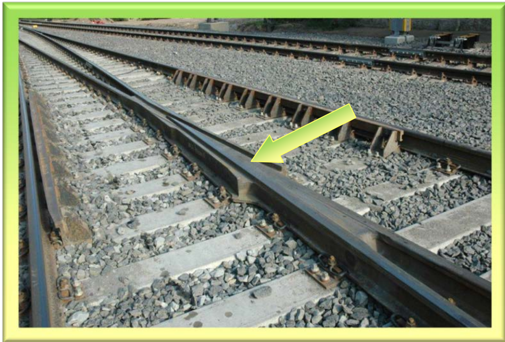
Obrázek 2 - Manganová srdcovka ve výhybce v železniční stanici Žandov
