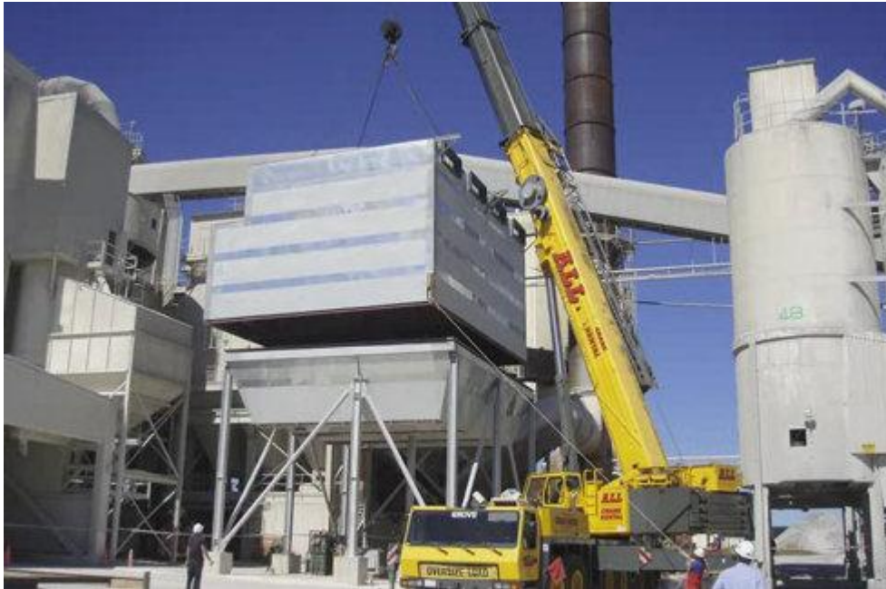
Obr 5 Montáž hadicového filtru, USA [16]
