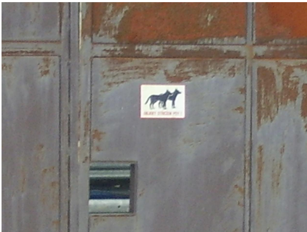
Obr. 26. Detail zadní brány, upozornění na psa v objektu
