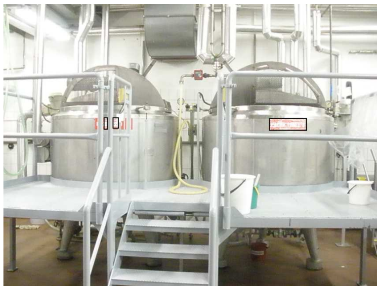
Obr. 8. Výrobní zařízení pro tepelné zpracování [vlastní]
