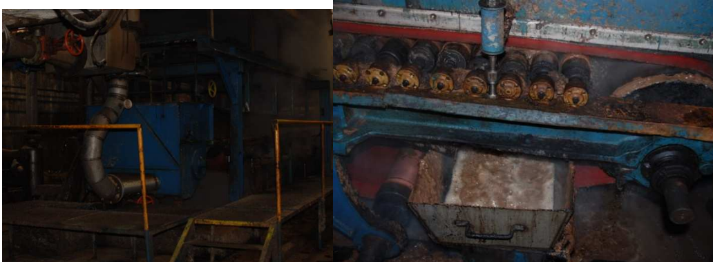
Obrázek 37 – Odvodňovací stroj (Vlastní foto); Obrázek 38 – Odvodňování (Vlastní foto)
