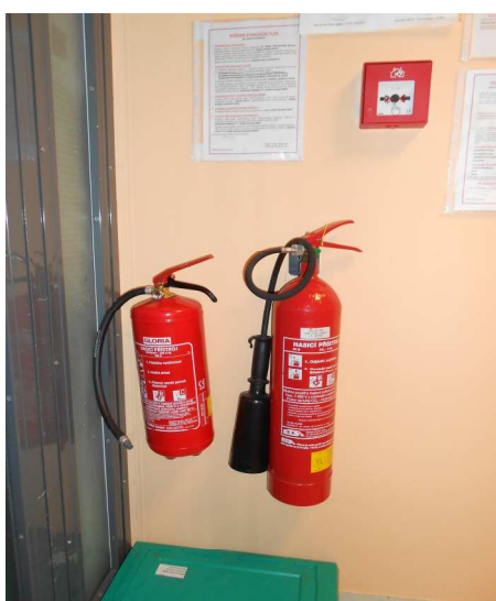
Obr. 15 Umístění hasicích přístrojů pod požární dokumentací
