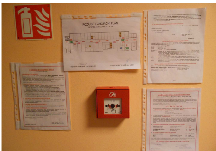
Obr. 14 Umístění požární dokumentace v objektu č.5a
