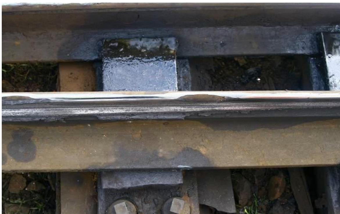
Obr. 6 Technický stav jazyka včetně opornice
