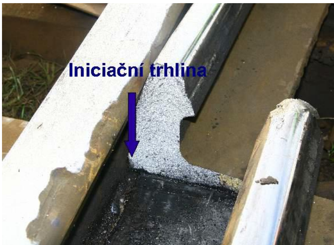
Obr. 5 Lom jazyka a iničiační trhlinka
