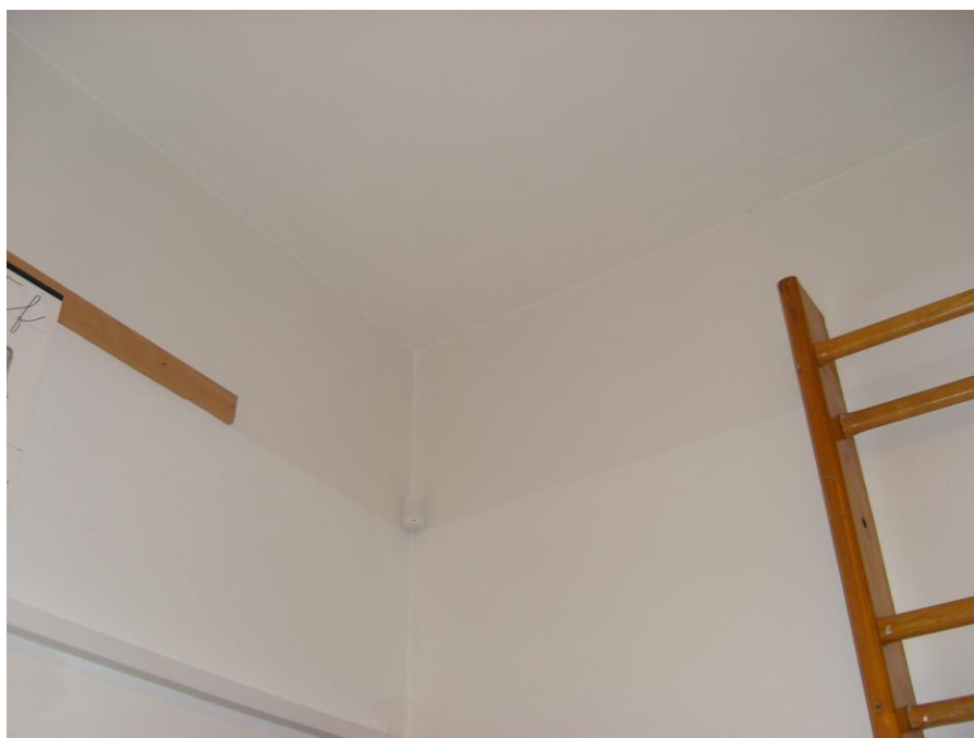
Obr. 8. Nevhodné částečné malování.
