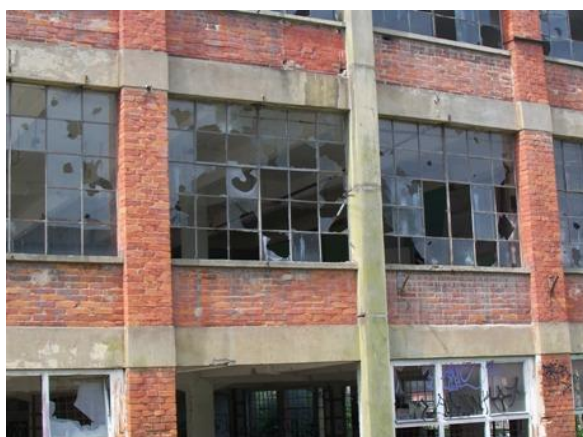
Fotopříloha 2: Detail na vytlučená okna.
