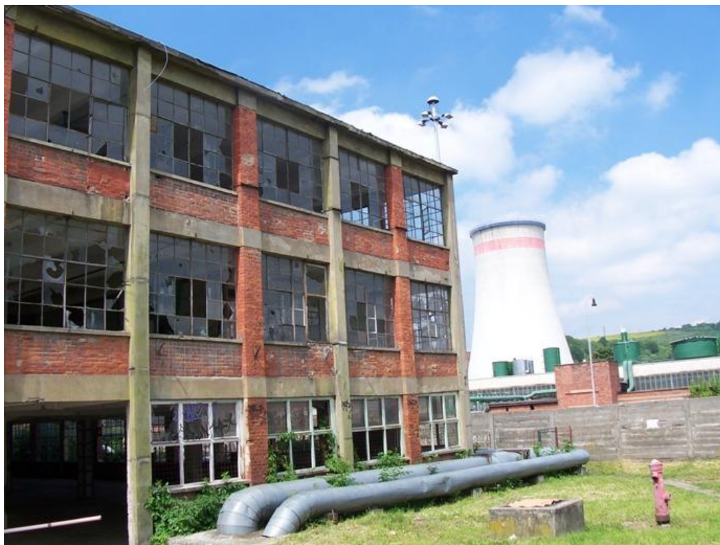
Fotopříloha 1: Budova číslo 26 ve východní části Bařova areálu nedaleko autobusového i vlakového nádraží je v dezolátním stavu.
