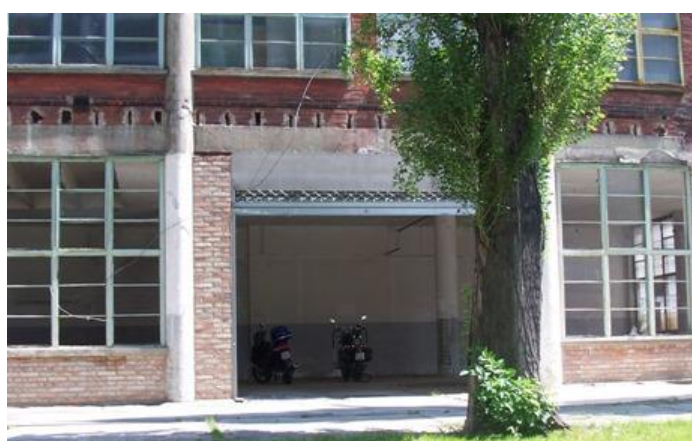
Fotopříloha 6: Část chátrající stavby slouží jako provizorní garáž.
