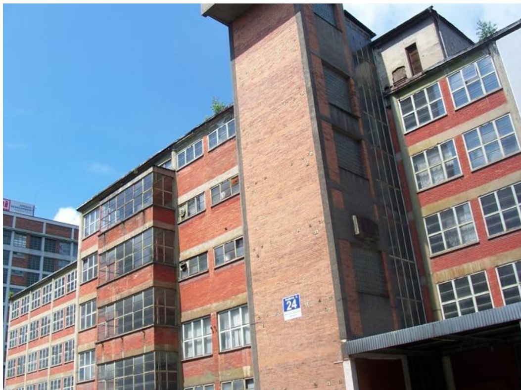
Fotopříloha 5: Technický stav opuštěné 24. budovy je o něco příznivější.
