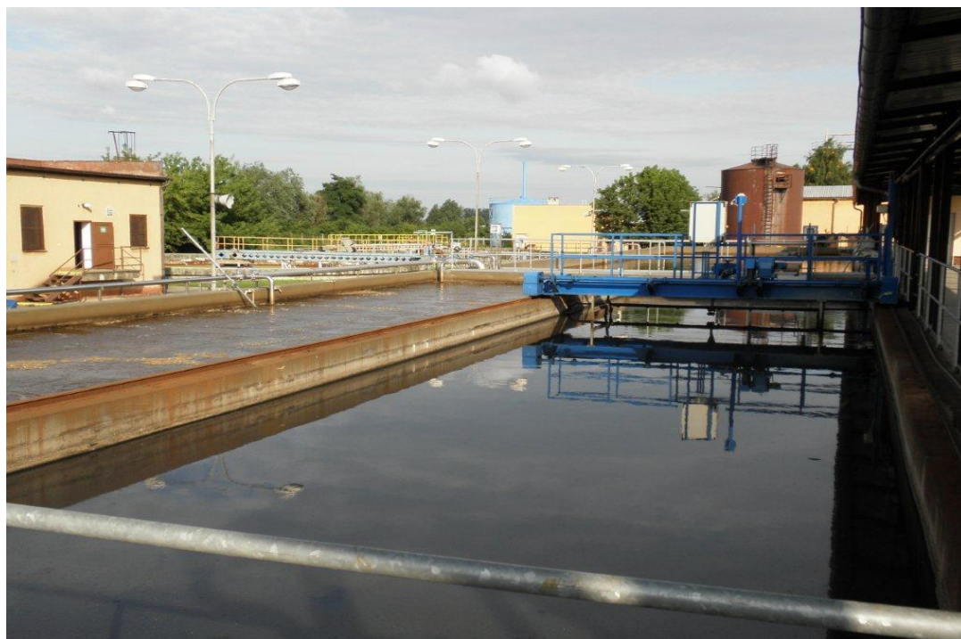
Obr. P 2 Čistírna odpadních vod Holešov [Zdroj: Fotografie společnosti]
