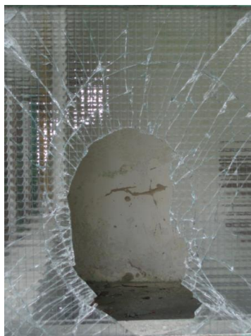
Obr. 23 Škoda způsobená pachatelem při útoku na objekt
