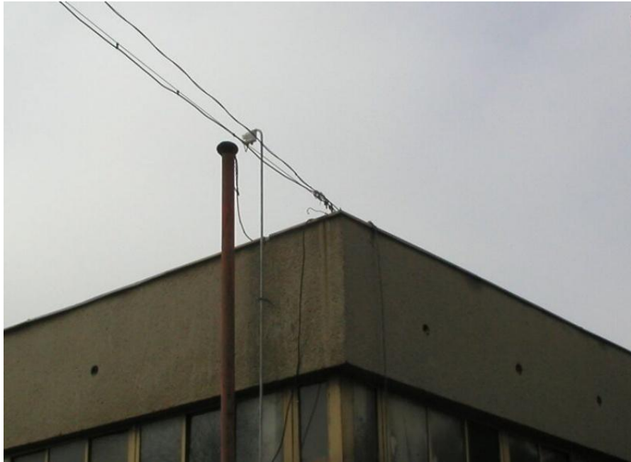
Obr. č. 10 Čidlo na detekci čpavku ve strojovně
