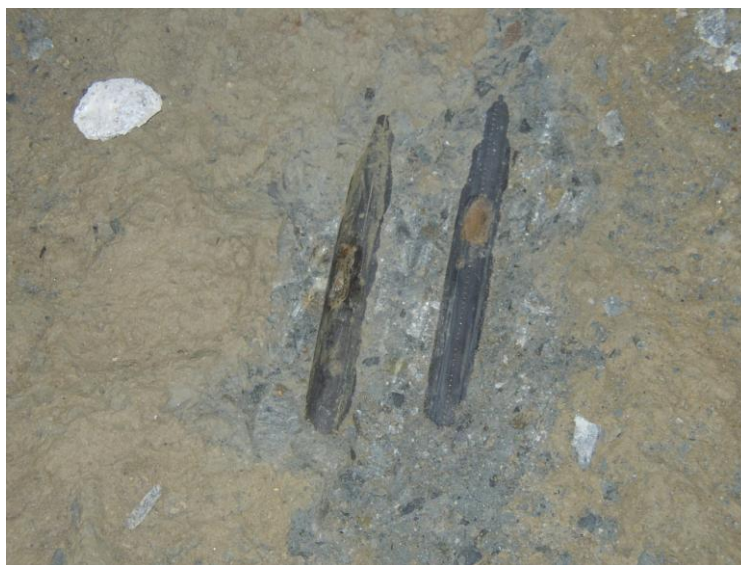
Obr. č. 11 Prasklá část potrubí v betonové ploše
