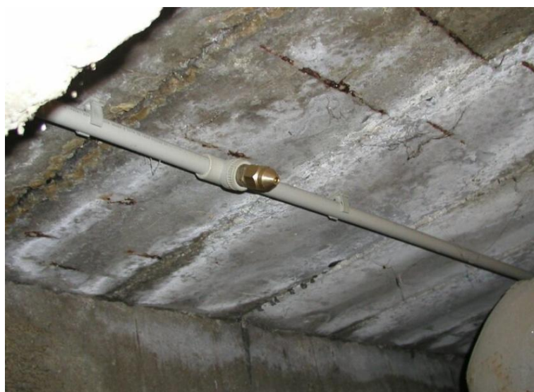
Obr. č. 9 Automatické zkrápění
