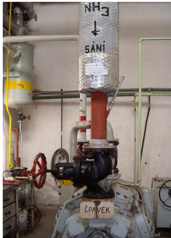
Obr. 3. Technologické zařízení pivovaru
