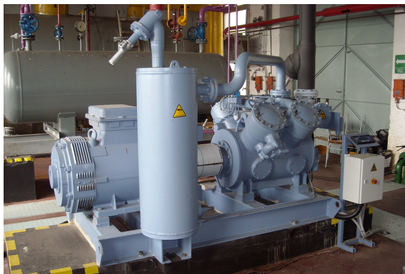
Obr. 1. Technologické zařízení zimního stadionu
