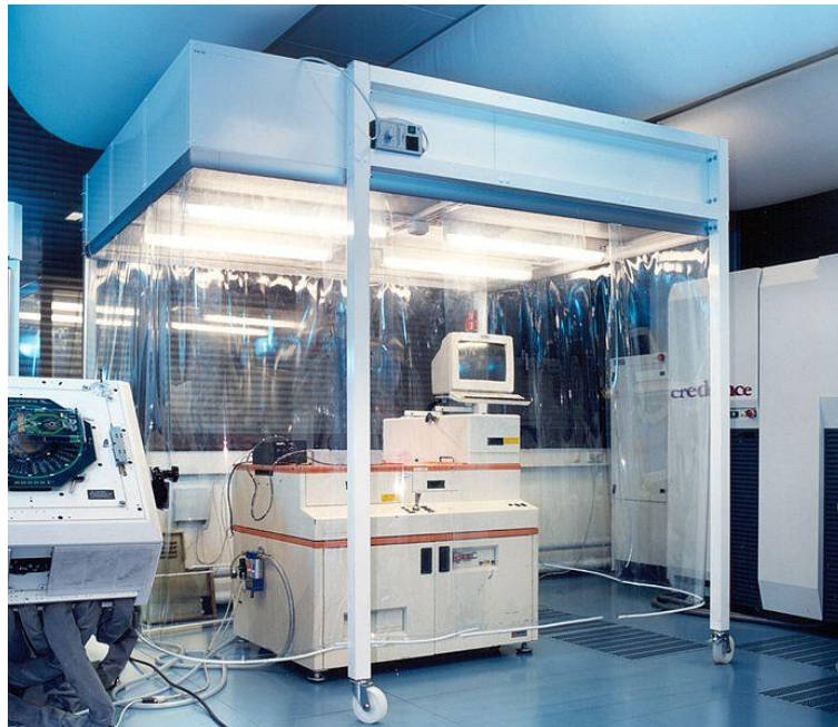
Obr. 28 Čistý prostor s měkkou stěnou [9]
