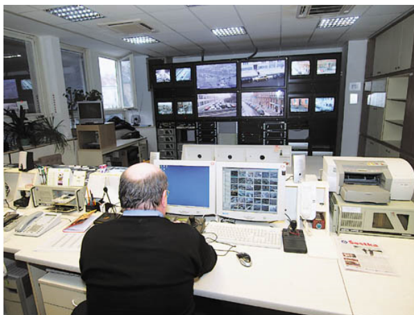
Obr.17: Monitorovací místnost kamerového systému[26]
