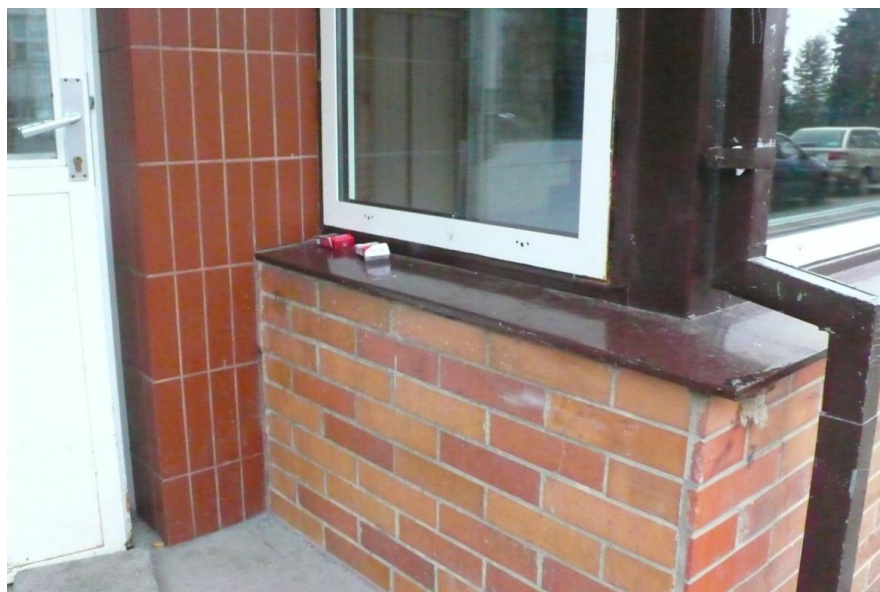
Obr. 30. Odložený nepořádek na parapetu budovy.
