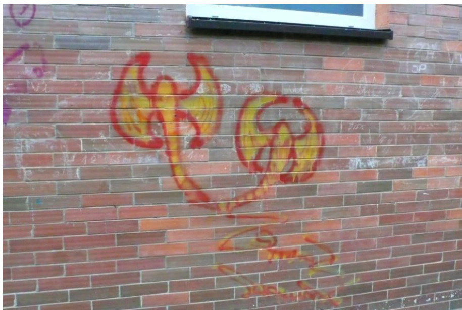
Obr. 27. Vandalismus na zadní straně objektu.
