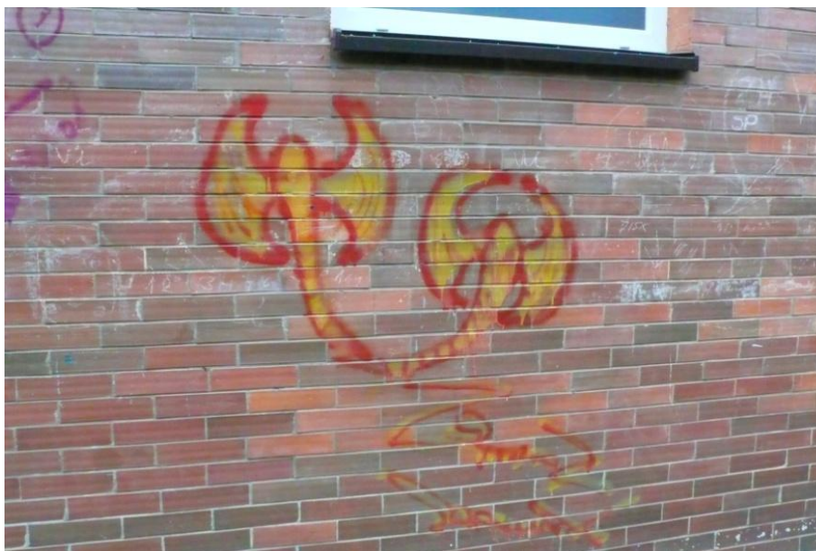
Obr. 14. Ukázka vandalismu v objektu.
