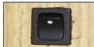
Obr. č. 31 – Pohled na spínač ventilátoru
