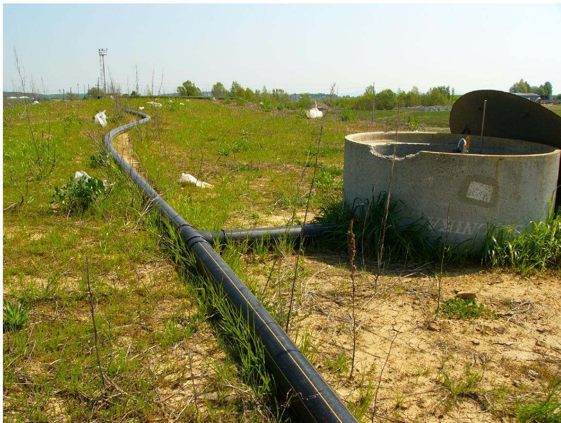
Obrázek 12: sběrné potrubí bioplynu na uzavřené etapě
