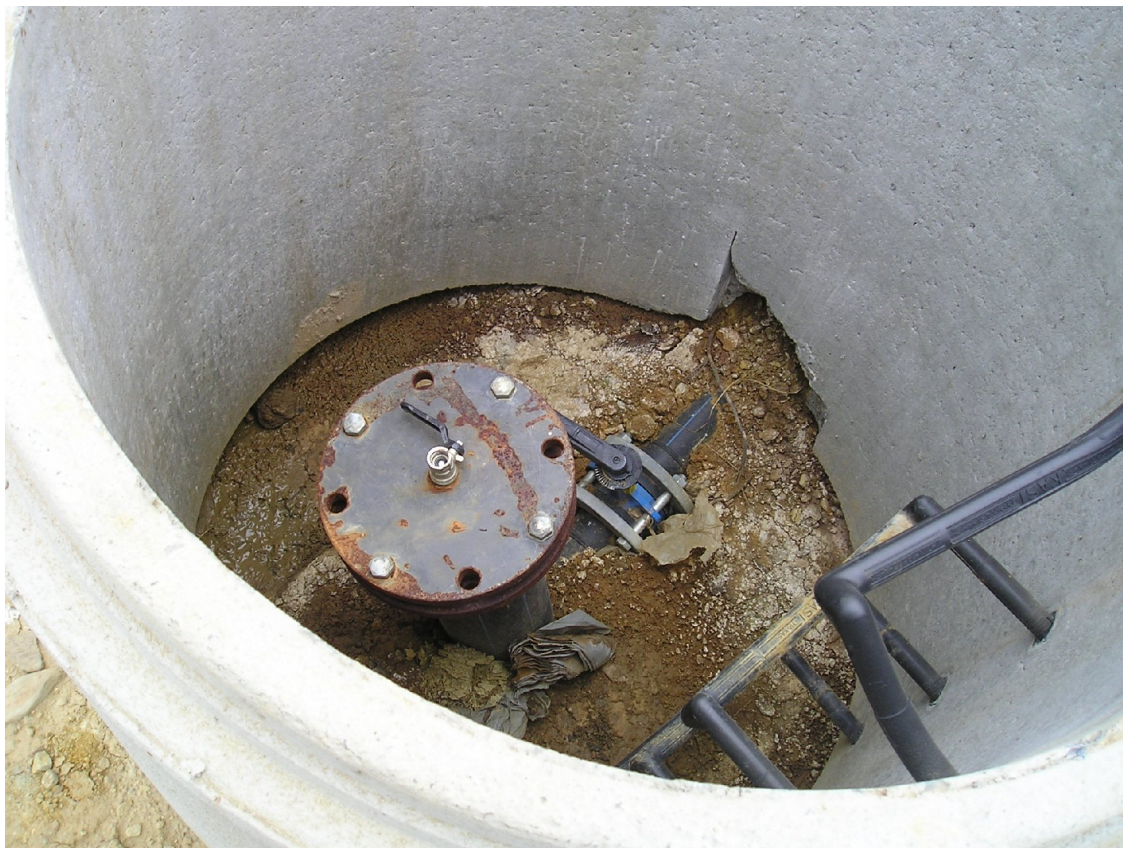
Obrázek 13: pohled do odplyňovací studny 1
