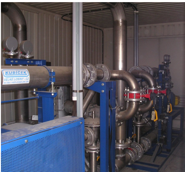
Obrázek 8: vnitřní vybavení stanice
