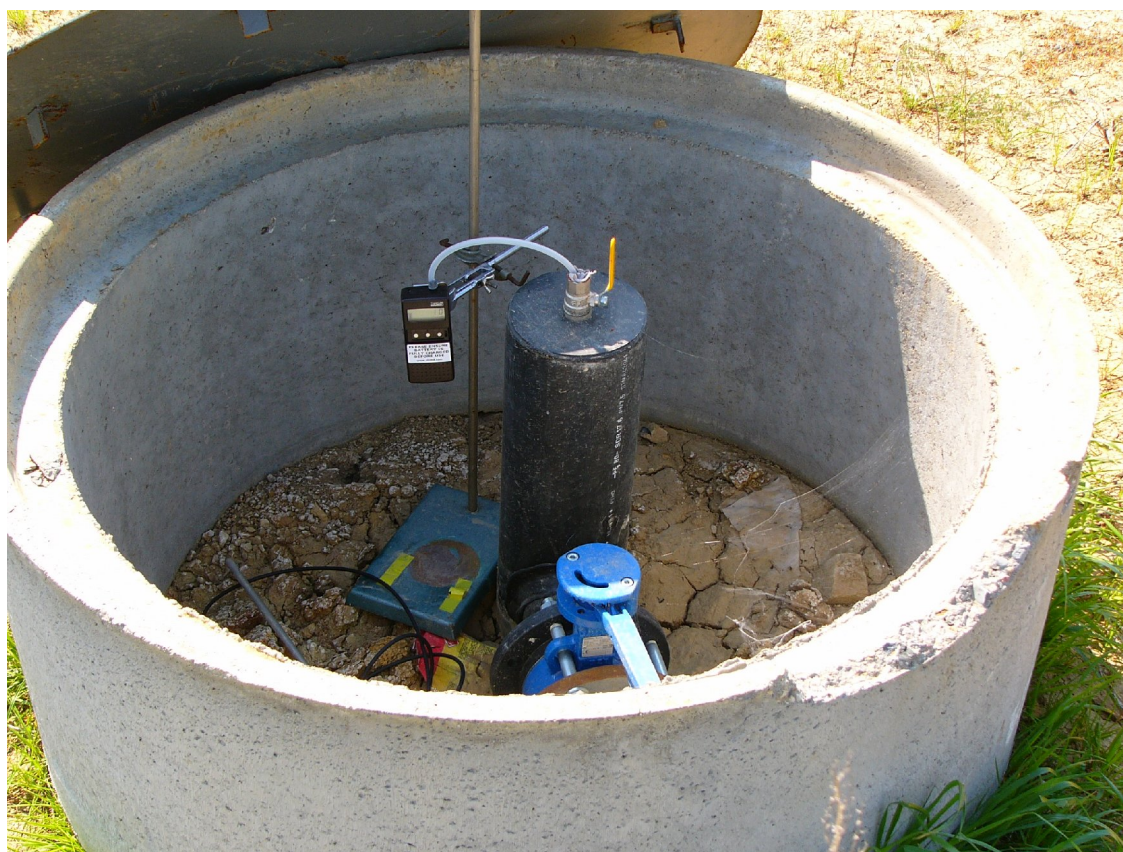
Obrázek 14: pohled do odplyňovací studny 2
